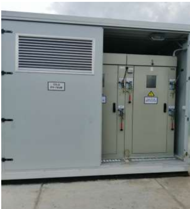
Комплексна трансформаторна підстанція PVIS/1000/10
