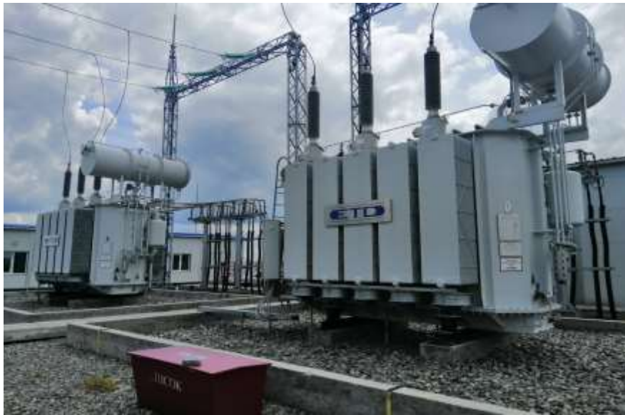
Трансформаторна підстанція потужністю 40 МВт
