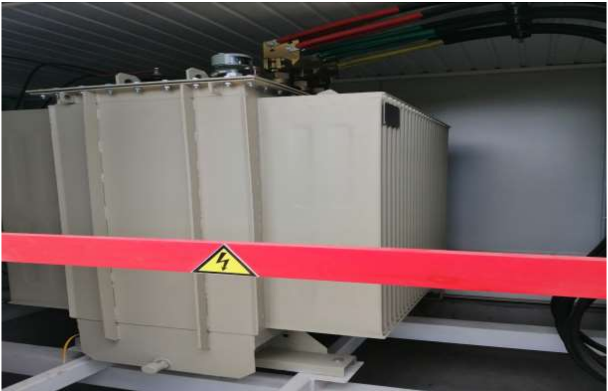
Трансформаторна підстанція потужністю 1 МВт
