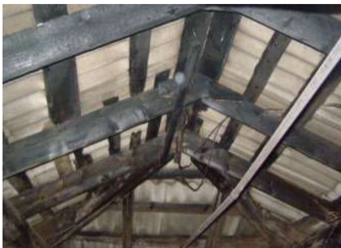
Рис. 1. Вигляд неопалювального горища, дерев'яні конструкції якого були вогнезахиснені ВВБЗР ДСА-1, після пожежі, ліквідованої на початковій стадії її розвитку
