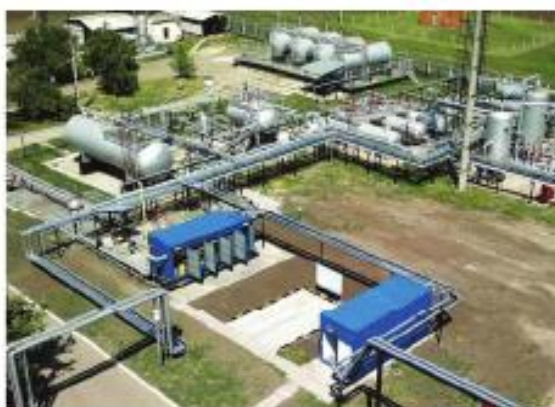
Рис. 2. Газовая винтовая станция SGV 315-20/0,5-25 U1 на УКПНГ, Бельск
