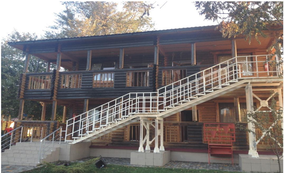
Рисунок 1.2 – Загальний вигляд термічних пошкоджень будівельних конструкцій корпусу № 6
