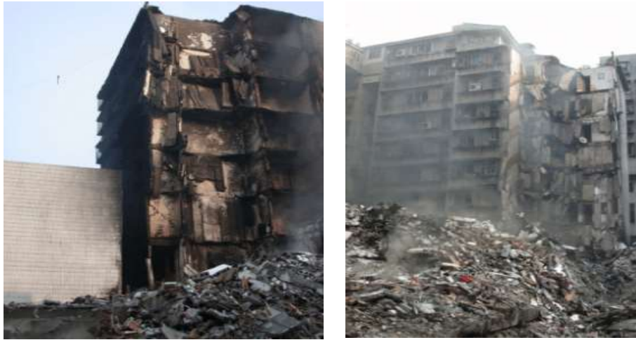
Рисунок 1.6 – Обвалення виробничої будівлі Hengzhou Tower, 2003, Китай
