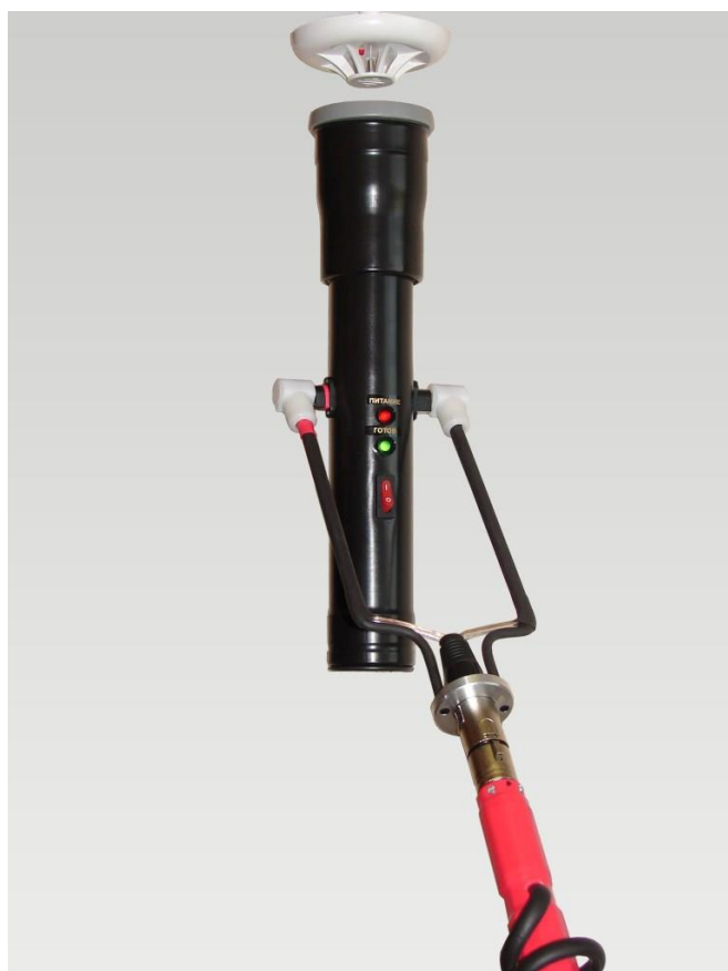
Рис. 1.16. Проведення випробування сповіщувача ТПТ-2 пристроєм «Теплотест-М»
