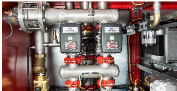
Рис. 1.17. Загальний вигляд стаціонарної системи пожежогасіння «One seven»
