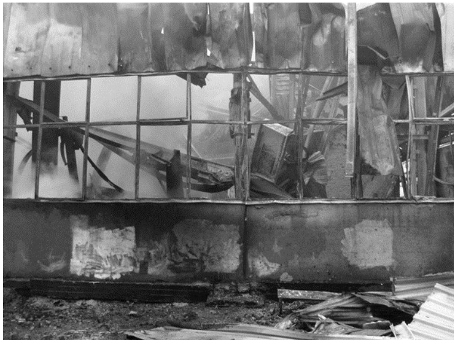
Рис. 1.1. Руйнування будівлі внаслідок втрати несучої здатності металевих будівельних конструкцій під час пожежі.
