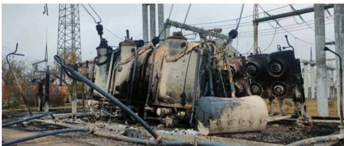
Рисунок 1.6 – Знищений російськими загарбниками автотрансформатор
