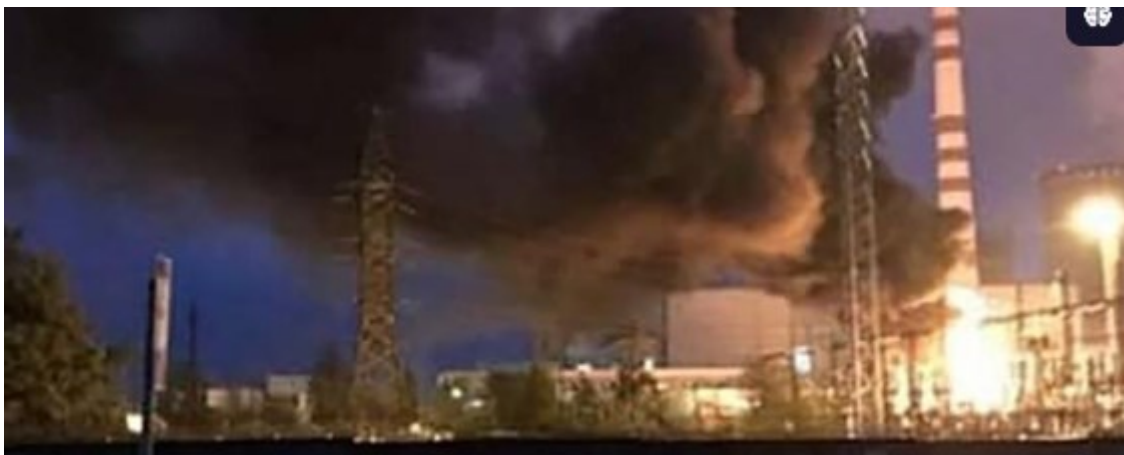
Рисунок 1.3 – Приклад загорання трансформатора 7АТ у ВП «Рівненська АЕС»
