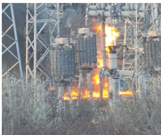
Рисунок 1.4 – Приклад результату загорання трансформатора струму на ВП «Південно-Українська АЕС»
