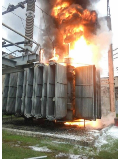
Рисунок 1.2 – Приклад пожежі трансформатора у м. Северодонецьку
