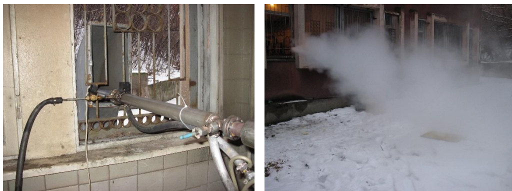
Рис. 5.10. Загальний вид установки пожежогасіння періодично-імпульсної дії
