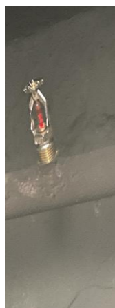
Рисунок 4.9 – Фото автоматичної спринклерної системи водяного пожежогасіння в споруді ВБ-40
