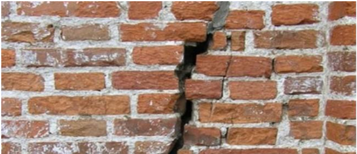
Рисунок 4.4 – Фотозображення одноповерхової приватної будівлі (пошкодження при дії техногенного землетрусу)
