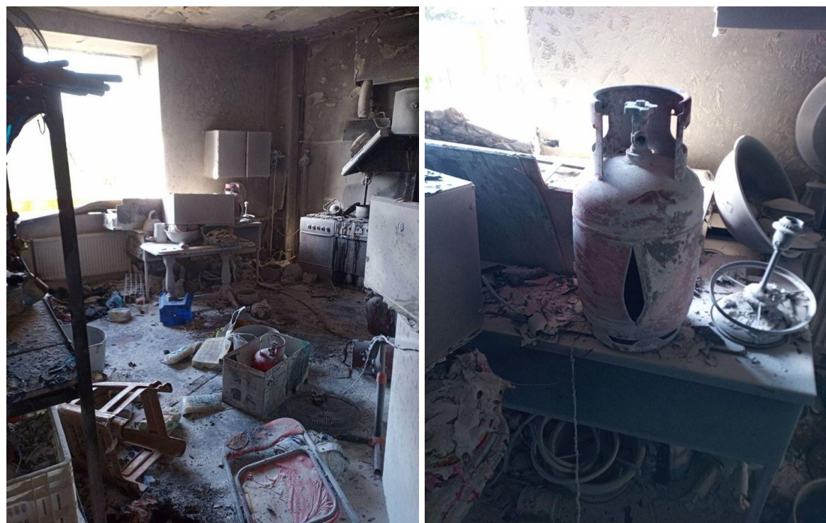
Рис. 2. Вибух газового балону у кімнаті багатоповерхового житлового будинку міста Харкова
