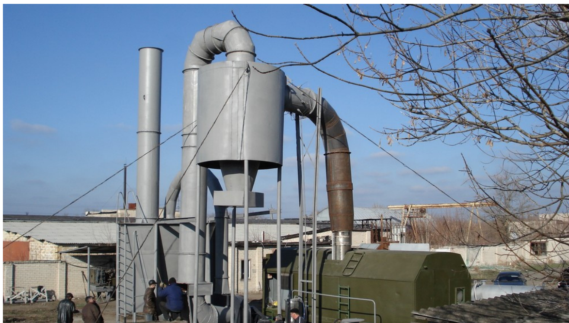
Рис. 2 – Загальний вигляд установки
